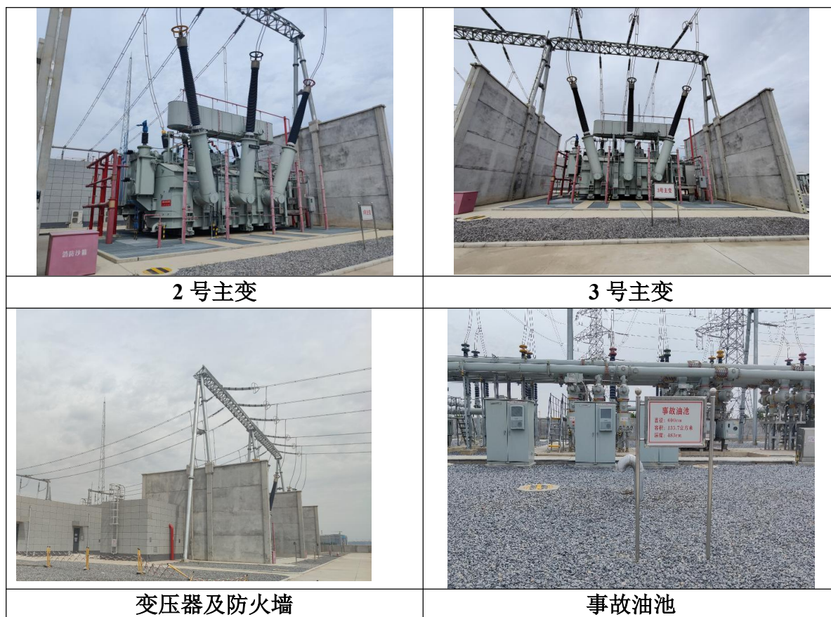
图 2-16 澎王 330kV 变电站内部分设施现状
