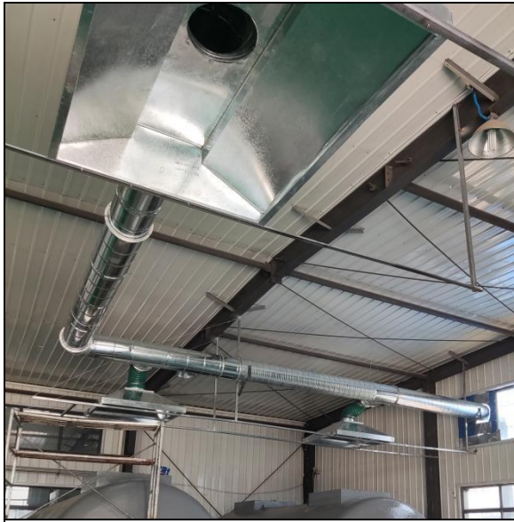
密闭集气管道
