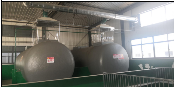
储油罐及废气收集设施
