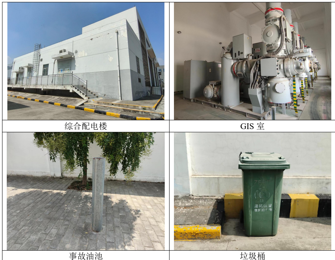
图 2-4 永东 110kV 变电站内部分设施现状
