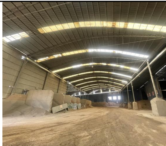
料仓内喷淋设施
