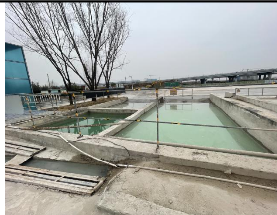
车辆清洗废水沉淀池
