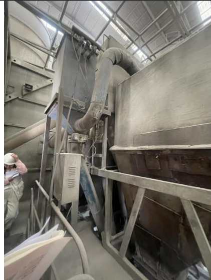
搅拌主机除尘器
