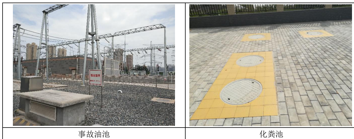
图 3.2-2 云谷 330kV 变电站现状照片
