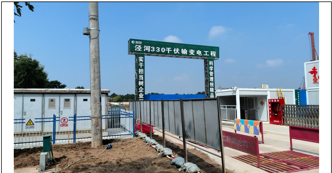
图 2-3 泾河 330kV 变电站现状
