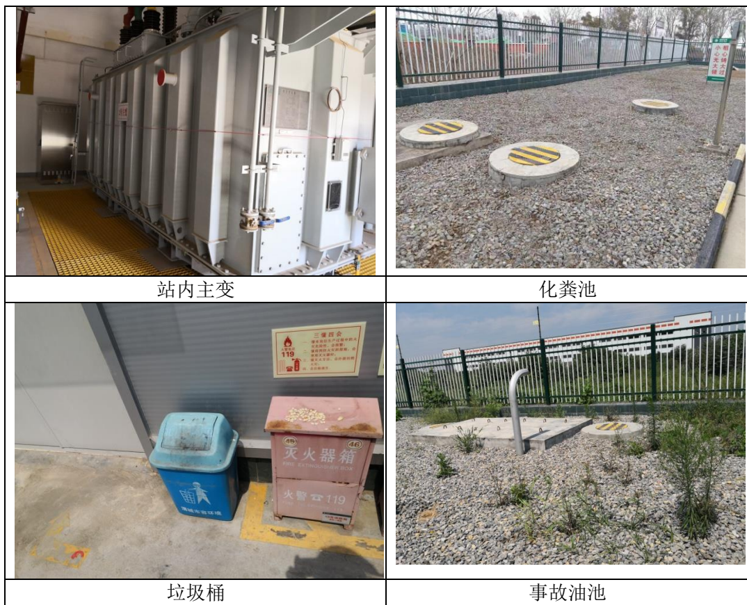
图 2-5 北杜 110kV 变电站内部分设施现状
