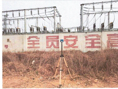
崇文 110kV 变电站西厂界
