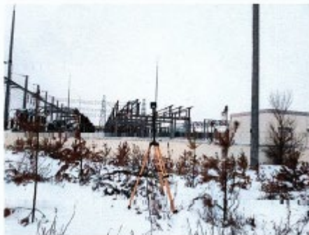
榆树湾 110kV 变电站东北厂界外 (展开监测方向)
