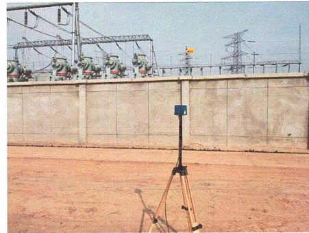
彭王 330kV 变电站电缆出线侧
