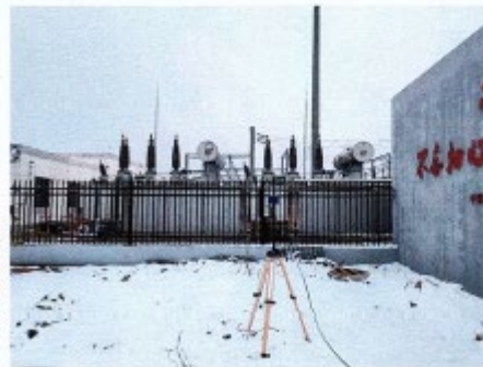
榆树湾 110kV 变电站西南厂界外
