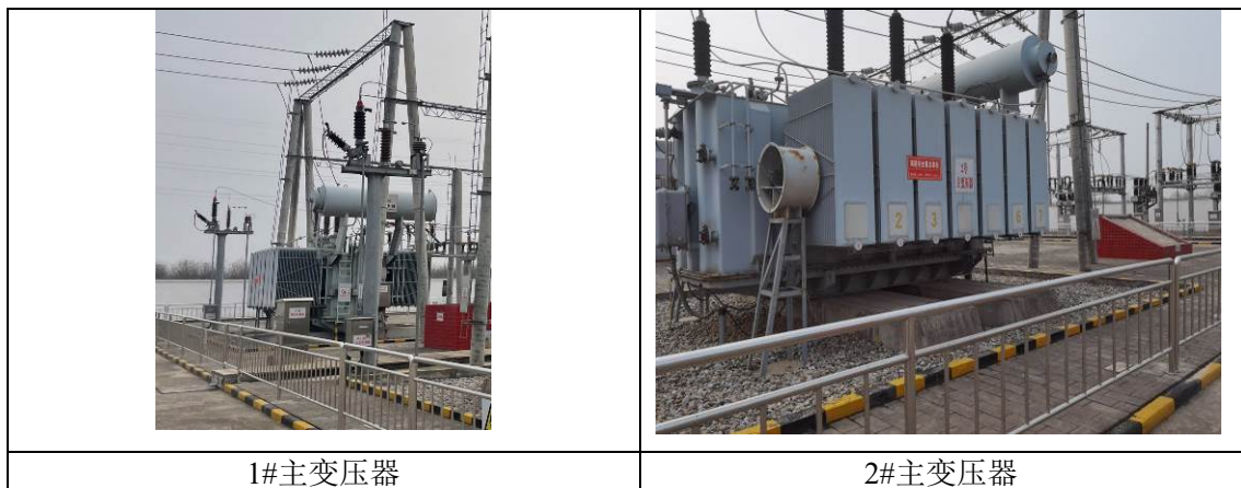
图 2-9 崇文 110kV 变电站内部分设施现状
